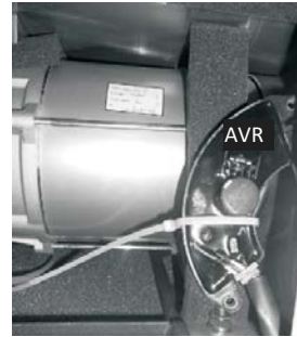
Figura B - Posizione del regolatore automatico di tensione (AVR). Alla fine, questo elemento potrebbe dover essere sostituito quando si usura.
